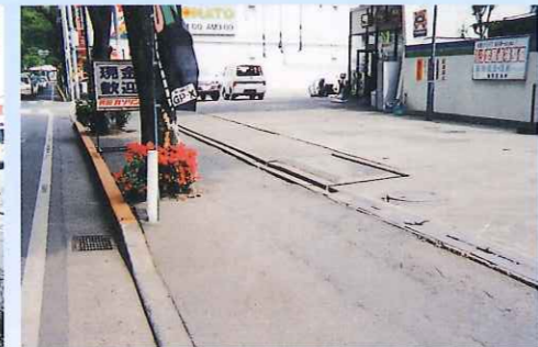
歩道に植えたケヤキがマンホールスタンドの地下タンクや排水ピットに侵入
