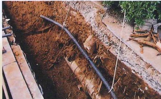
歩道の下に埋設された配水管やケーブル
