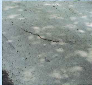
桜の樹木による根茎侵害で歩道に亀裂
